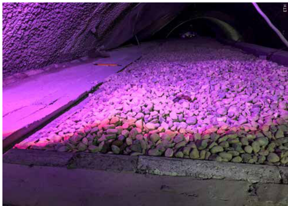
Blick in den ersten Wärmespeicher. Die Steine mit einem Durchmesser von rund 2-3 cm stammen aus Flussablagerungen in der Nähe von Zürich.
