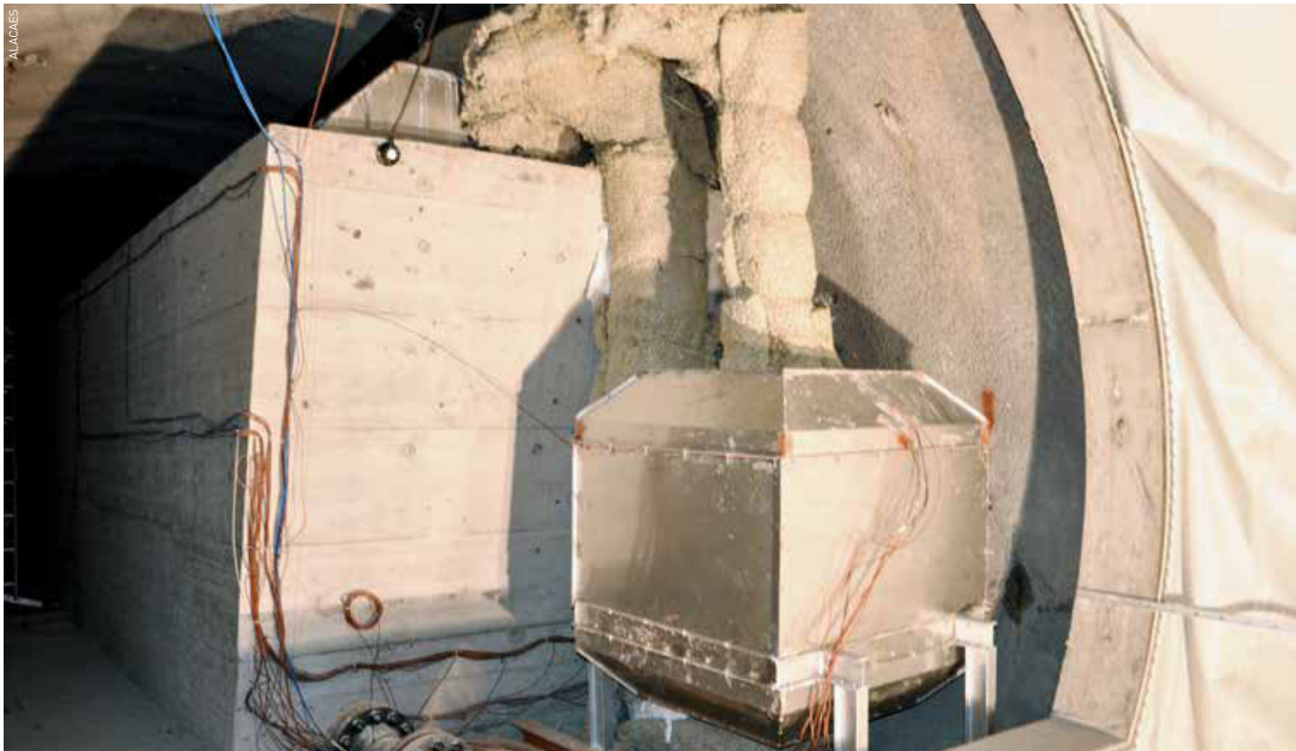
Sicht auf die beiden Wärmespeicher. Links befindet sich der erste Wärmespeicher, der mit einer Gesteinsschüttung gefüllt ist. Rechts der zweite Wärmespeicher, in welchem Wärme im Phasenwechsel einer in Stahlrohre abgefüllten Metalllegierung gespeichert wird.
